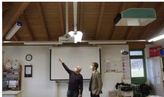
Bodo Frommelt und Bürgermeister S. Hausstetter begutachten die installierten Luftreinigungsgeräte.
